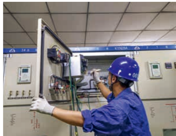
配电室高压设备耐压试验
